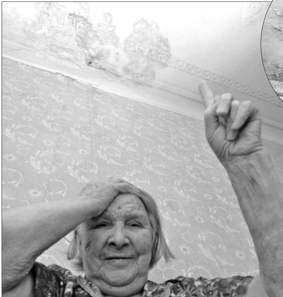
Каждую неделю отваливается кусок штукатурки!
