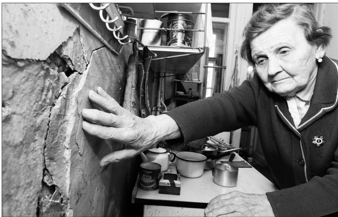
Александра Бульга живет в разрушающейся квартире
