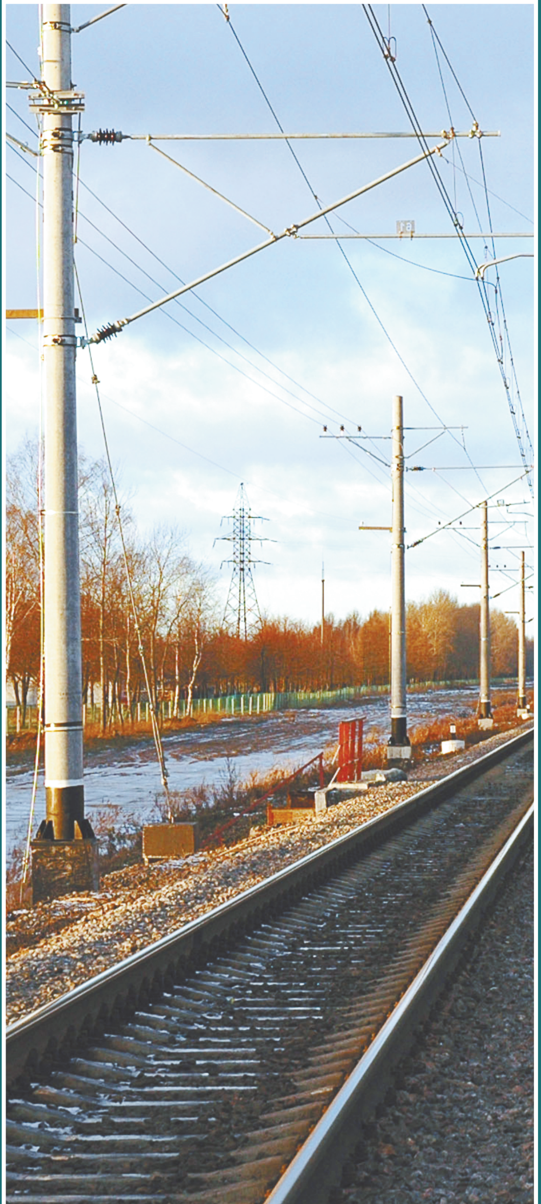
Контактная сеть КС-200-06 для скорости движения 200 км/ч на перегоне Саблино - Тосно Октябрьской железной дороги
