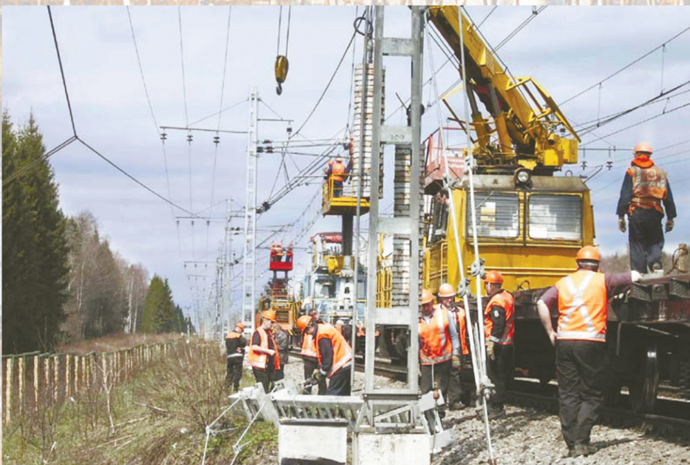
Монтаж опытных участков контактной сети для скорости движения 250 км/ч на участке Калашниково - Лихославль Октябрьской железной дороги
