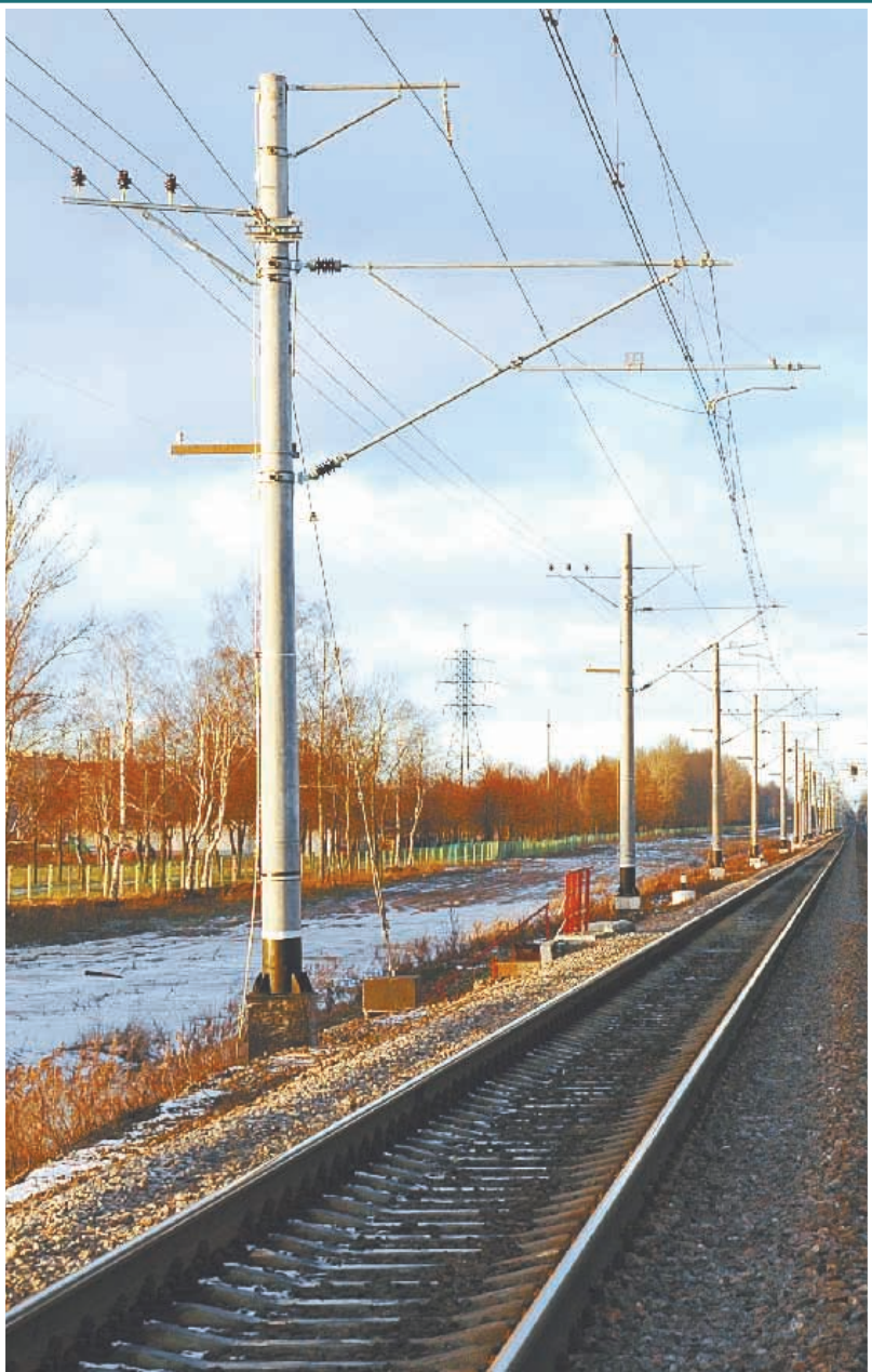
Контактная сеть КС-200-06 для скорости движения 200 км/ч на перегоне Саблино - Тосно Октябрьской железной дороги
