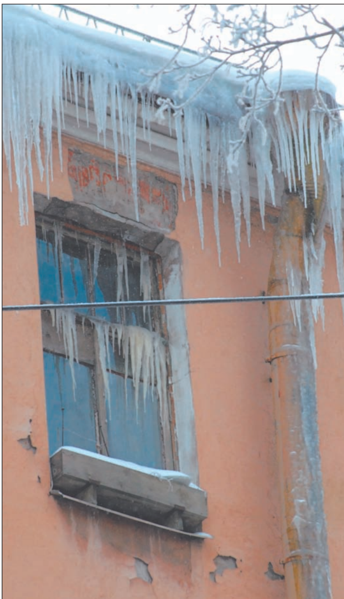
Сосульки, грозящие прохожим, вовремя сбивают далеко не везде
