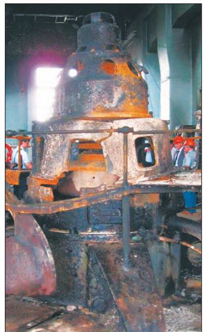
ГЭС выведена из строя
