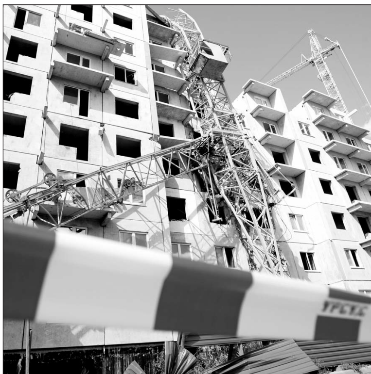
На одной из строек выявлены серьезные нарушения
