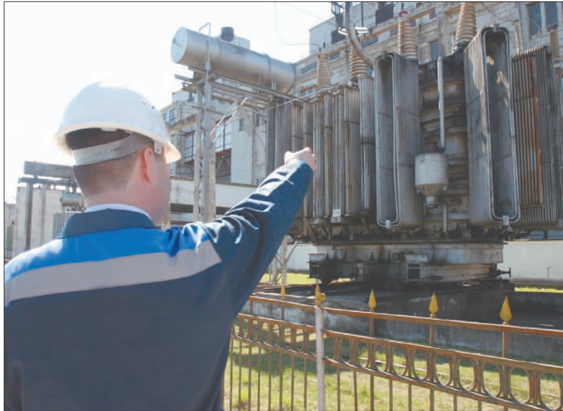
Ответственным за ЧП на подстанции снова станет нечто неодушевленное?
