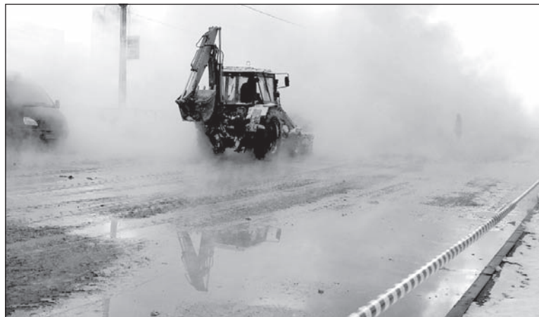
На проспекте Энгельса кипятком залило километр дороги
