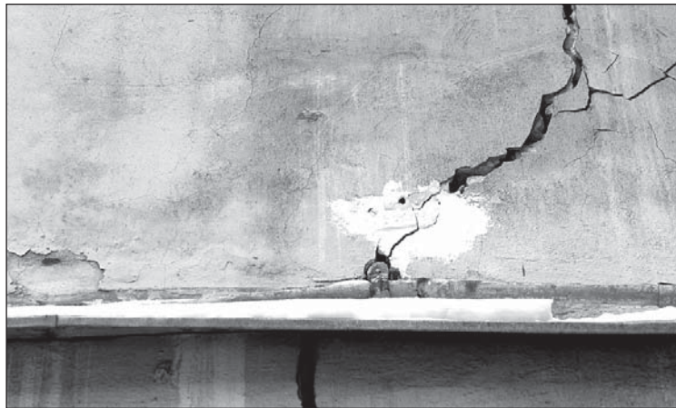
Многие дома в городе трещат по швам из-за таких же горе-ремонтников, что поработали в «Юности»
